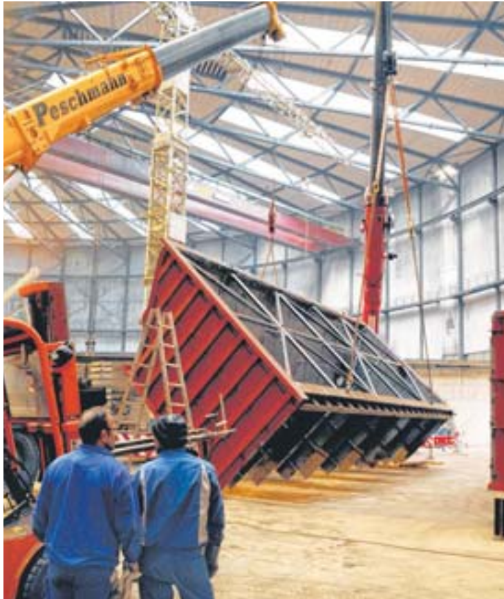
Die schweren Stahlhauben des Wärmetauschers wurden gestern an Kränen für den Abtransport vorbereitet.
